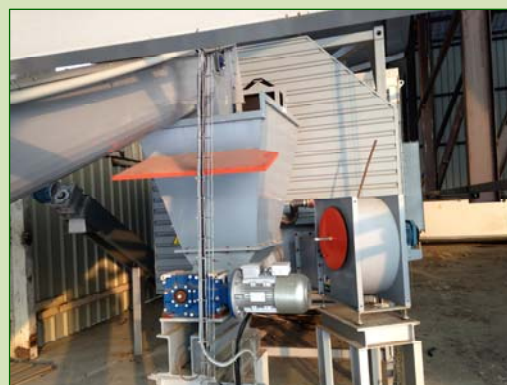
GENERATEUR D'AIR CHAUD APISA PUISSANCE 2 MW
